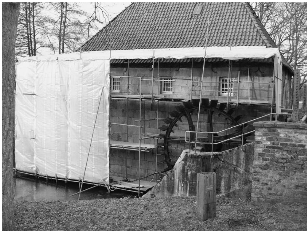
Restauratie van de muren van de Mallumse Molen bij Eibergen, uitgevoerd door Bouwbedrijf Hoffman uit Beltrum (foto Walter Vaags).
