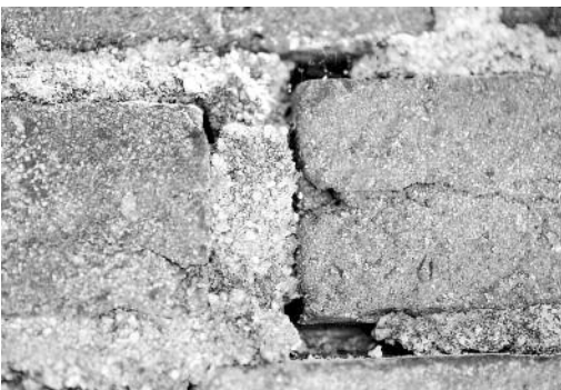
Achter het voegwerk zitten 'kanaaltjes'.
