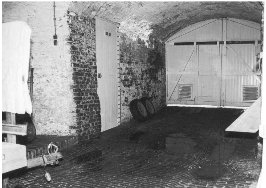
Enkele uren na een hevige regenbui met veel wind komt het water door de muur naar beneden en drupt in de invaart uit de toog en zorgt voor grote plassen op de vloer. (alle foto's Toon van As)
