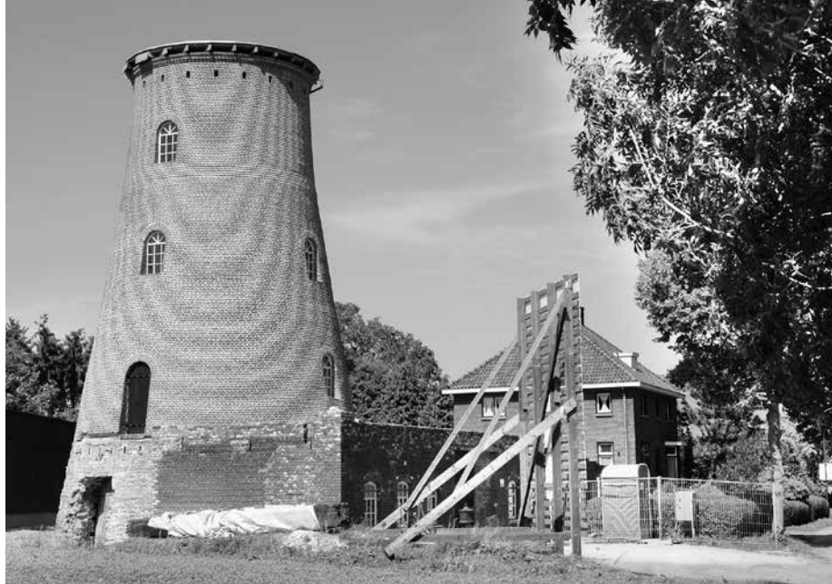
▲ De Antonius te Eerde ontdaan van een deel van de ombouw en de romp compleeteerd tot kaphoogte (foto: E. Janssen, 15 augustus 2009).
