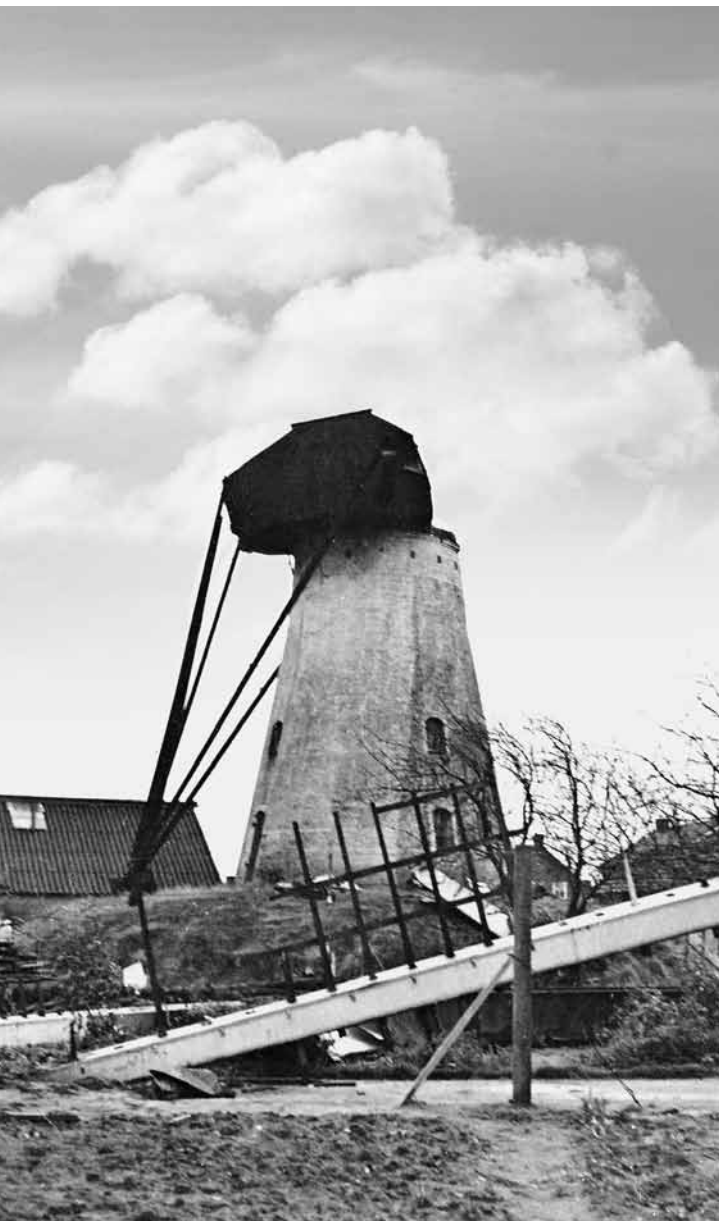
De op 18 november 1963 verongelukte Deen. Niet alleen brak de as, maar er ontstond ook brand, maar die kon gelukkig snel worden geblust. In 1968 werd de molen hersteld.
