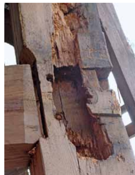
▲ De pen van de legeringsbalk blijkt volledig weggerot te zijn, om over de stijl maar te zwijgen.
