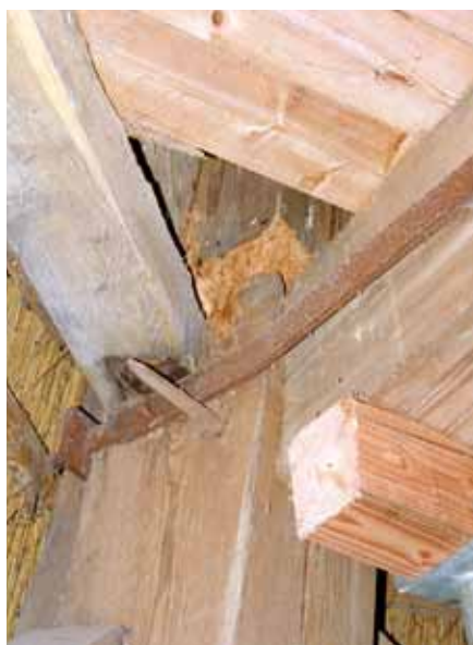
▲ De zuidweststijl met de in 1949 aangebrachte strop en de stempeling van 2012.
