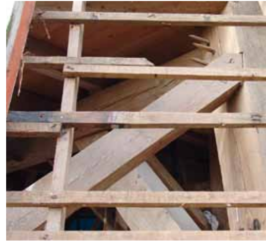
▲ Voormalige heklaten zijn goed herkenbaar aan verfstrepen en gaten van de mid-denzoomlaten.
