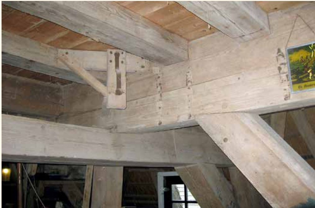
Onder de steenzoldervloer wijzen een verzwaarde losse legeringsbalk, alsmede het feit dat men de kruisende vaste legeringsbalk ter plaats juist dunner heeft gemaakt om zo plaats te kunnen bieden aan een vloer, in de richting van een vroegere pelsteen. Het molenachtkant loopt naar onder echter door tot op stellinghoogte. Dit betekent dat de pelsteen dan tamelijk hoog in de molen moet hebben gelegen en niet op stellingniveau, wat in de bekende pelmolengebieden Groningen en de Zaanstreek de gebruikelijke positie was. Of we hier met een regionale uitvoering te maken hebben, en of de molen in zijn beginjaren in Oostendorp wellicht ook nog gepeld heeft? We weten het niet. Misschien zijn er lezers die daar meer informatie over kunnen geven. De functie van de tegen de losse balk aangebrachte lichte constructie, midden op de foto, is onduidelijk (foto Martin van Til).
