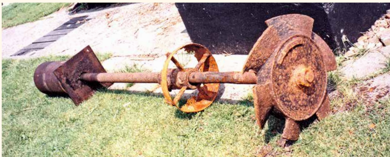
Schroefpomp van de Groenendijksemolen. Onder en boven de schoepen zat voorheen een eivormige stroomlijnmantel, maar rond 1990 was die al zo goed als weggeroest (foto Jan Hofstra, 1998).
