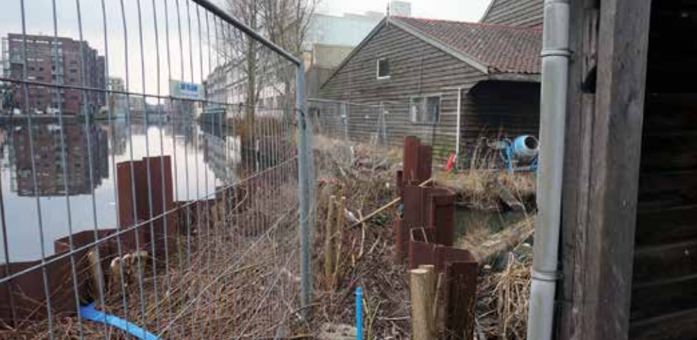
De (tijdelijke) stalen damwand sluit het balkengat af van de Kostverlorenvaart (foto Willem Roose, maart 2018)
