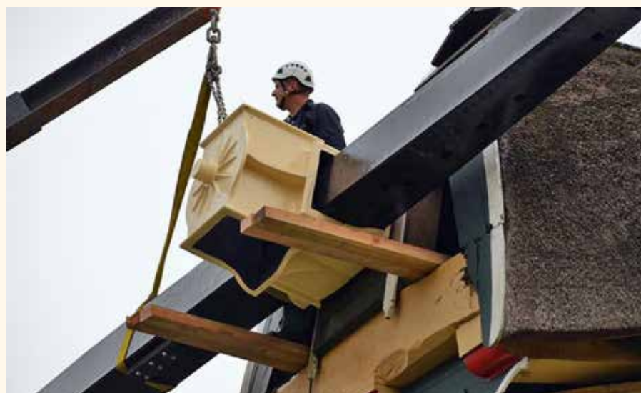
Het insteken van de gerestaureerde binnenroede door molenmaker Vaags uit Aalten. Omdat er ter plaatse geen kraan kon komen, is de roede horizontaal in de as geschoven. De askop, voorheen rood geschilderd, is nu geel. De walpen en ster zullen nog wel in een andere tint worden geschilderd (foto Gert Groenenboom).
