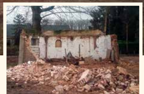
Restanten van de molen aan de Dorpsstraat Pesse. (foto J.N.J. Vondeling 24 januari 2018).
