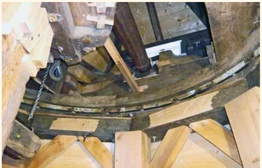
Een kijkje vanaf de kapzoldervloer omhoog. We zien onder meer het nieuwgebouwde achtkant, de door Adriaens na 1972 vervaardigde kap met daarin de oude gietijzeren as en de oorspronkelijke koningsspil, en op de overgang van achtkant naar kap het Engels kruierwerk dat uit de jaren dertig dateert (foto Jan Scheirs).
